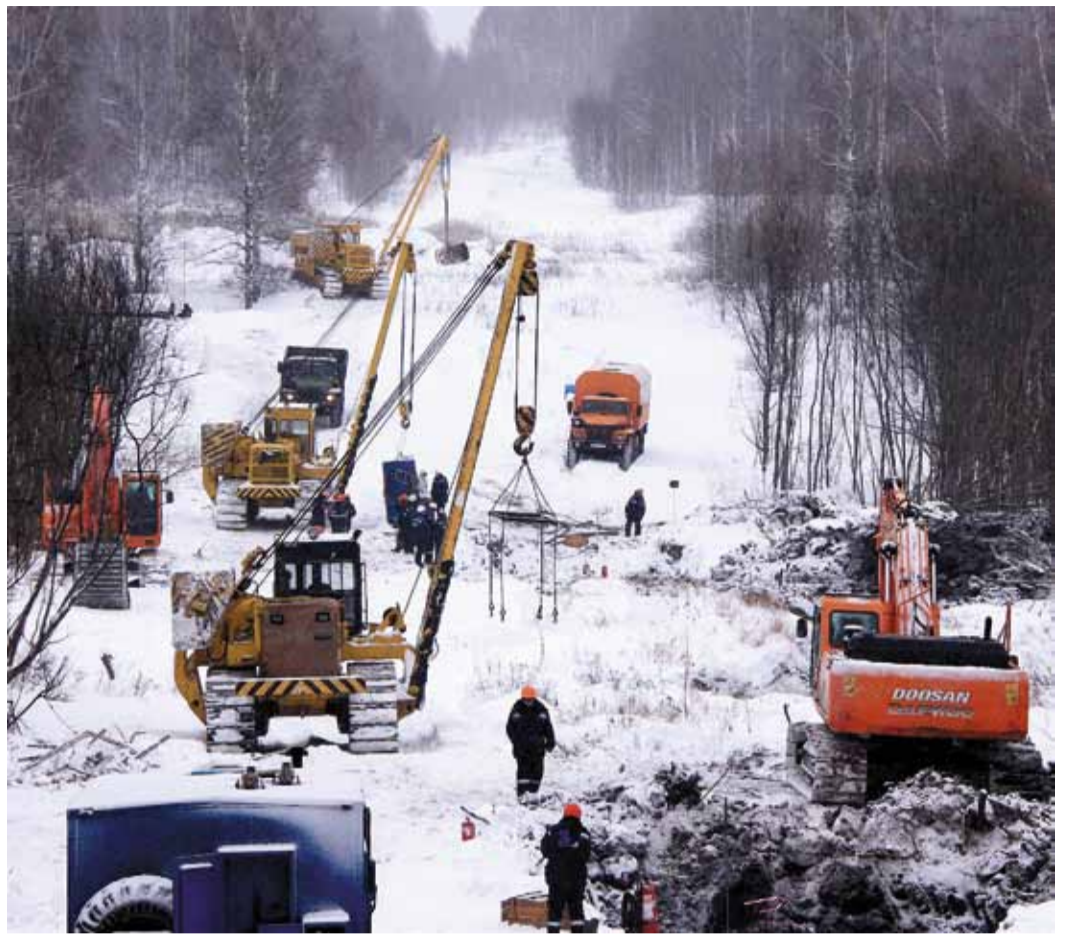
Плановый ремонт МГ Парабель – Кузбасс ведется на всех четырех промплощадках Томского ЛПУМГ «Газпром трансгаз Томск»
