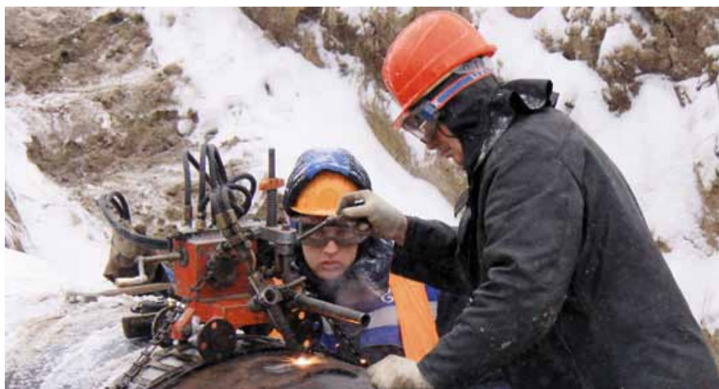
За считанные минуты резак «Орбиты» отрезал второй край трубы, не требующий дополнительной обработки
